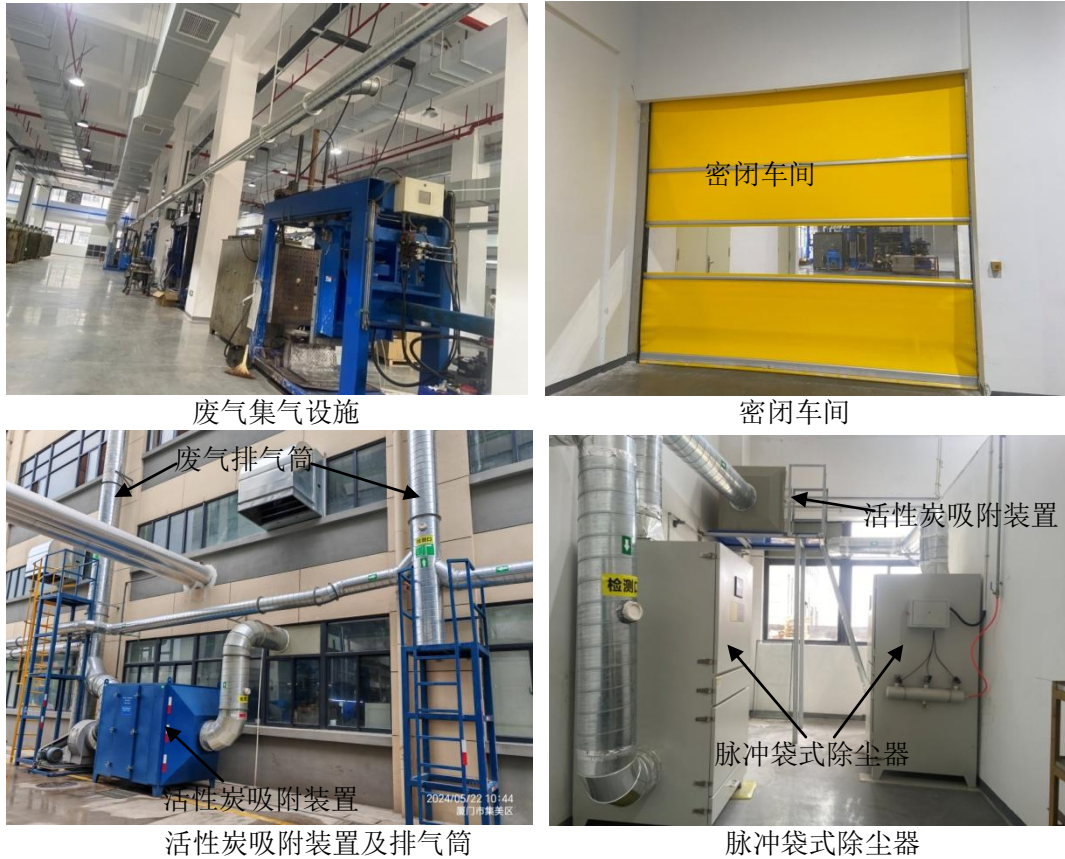
图 3-3 本项目废气收集、处理及排放设施照片
